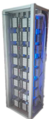
LF1 batterij 48V-6.3kWh 2017 (Destelbergen)
